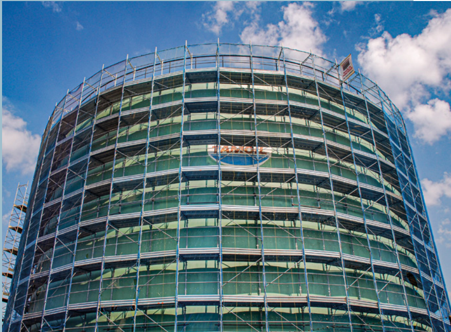
Tamoil Tank, San Martino di Trecate (NO)
